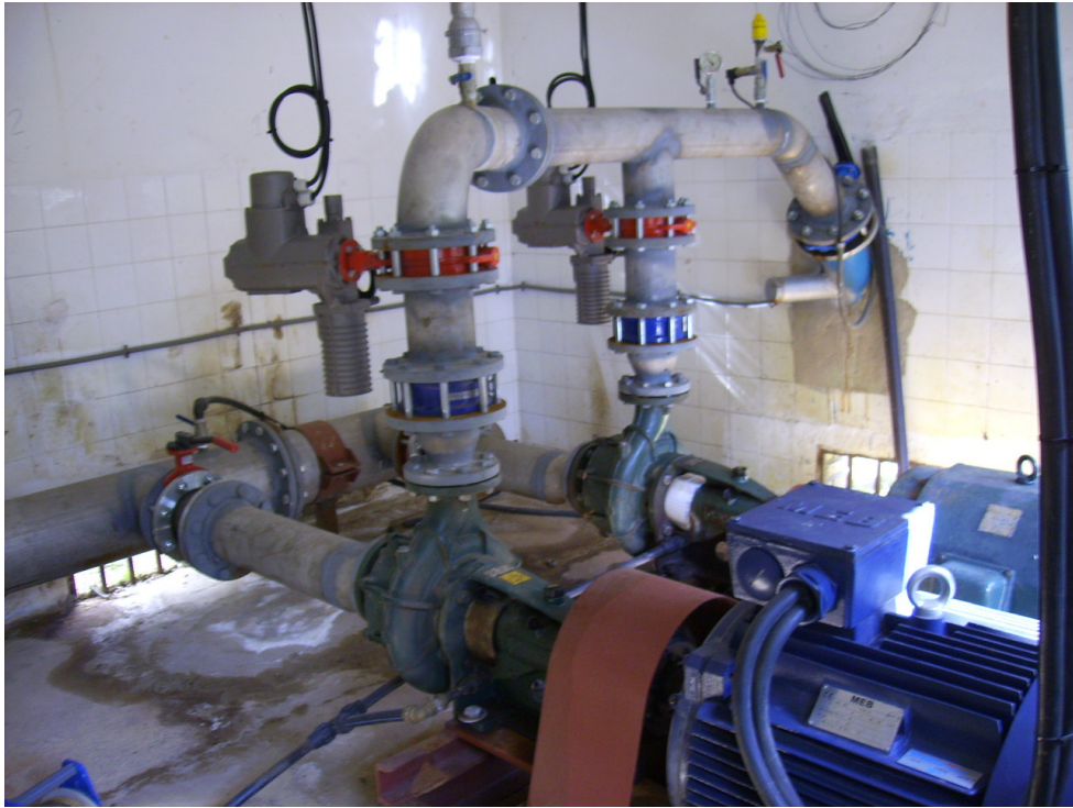
Parque de bombas en caseta existente junto al sondeo nº 3.
