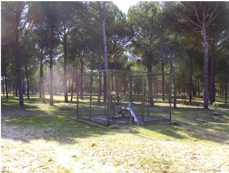
Vista general sondeo de abastecimiento nº4 (1141-5-0106).
