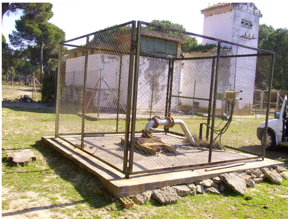
Vista general sondeo de abastecimiento nº3 (1141-5-0105).
